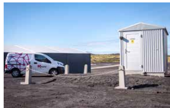
Við leggjum mikla áherslu á vörubrúun og að fylgjast með nýrri tækni. Á þessari mynd er dreifstöðvahuús sem er hannað og smíðað í Rafal.
