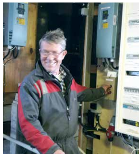
Jón Valgarðsson á Eystra-Miðfelli að ræsa nýja öxuldælu við borholu félagsins árið 2015.
