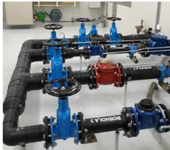
Dælustöð vatnsveitu HEF við Köldukvísl.
