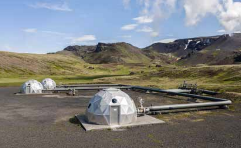
Niðurdælingarbrunnar við Hellisheiðarvirkjun. / Ljós. Sigurður Ólafur Sigurðsson.
