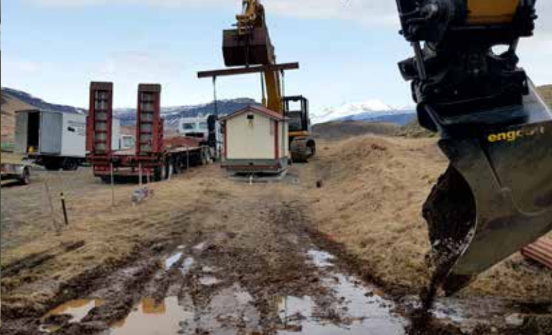
Þegar dælustöðvar eru lagðar niður vegna breytinga er upplagt að nota dæluhúsið aftur á nýjum stað. Dæluhús fært frá Hrafnabjörgum að Bjarteyjarsandi, Jónas Guðmundsson og Arnfinnur Jónasson sáu um flutninginn.
