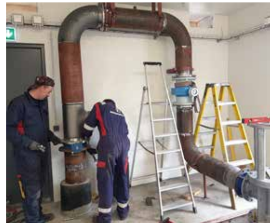
Hér er verið að vinna í nýju borholuhúsi á Hjalteyri. Frá vinstri: Vignir Sigurðsson, stálsmiður og Mikael Grönvold Jónsson, verkamaður.
