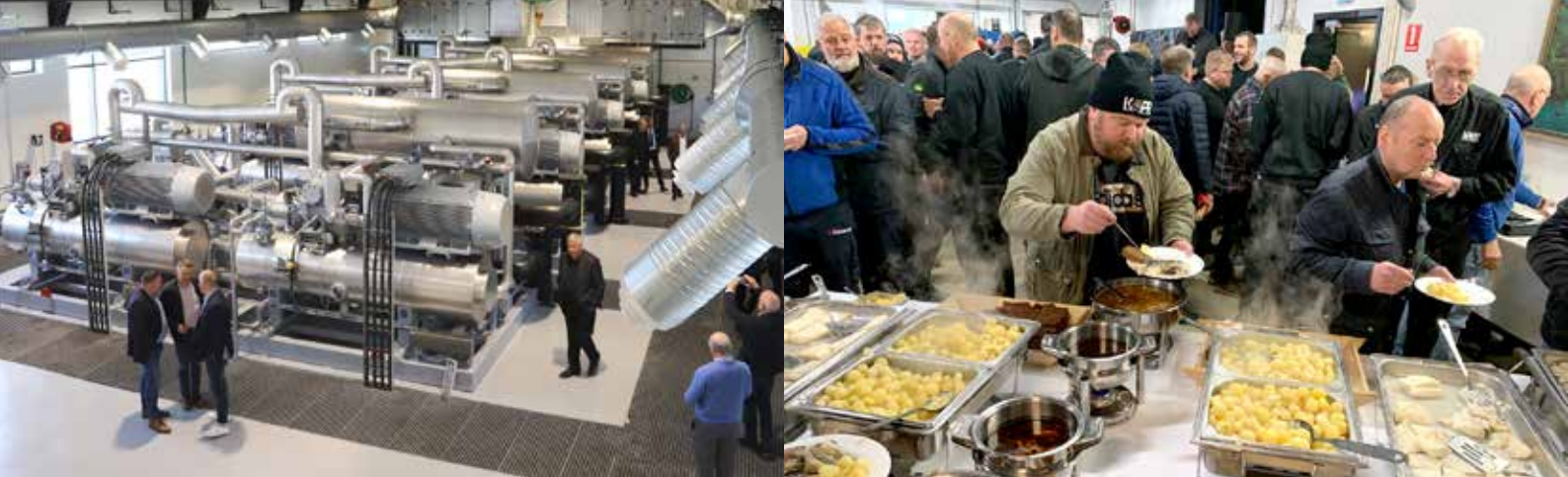
KAPP ehf. klárar uppsetningu á ammoníaks- og vélbúnaði fyrir varmadælustöð HS Veitna í Vestmannaeyjum.
