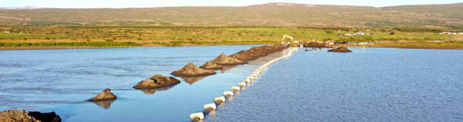
Útrásarlögn fráveitu lögð í Lagarfljót sumarið 2020. Lögnin er 1. áfangi í endurbótum á fráveitu og mun þjóna íbúum á Egilsstöðum og í Fellabæ.
