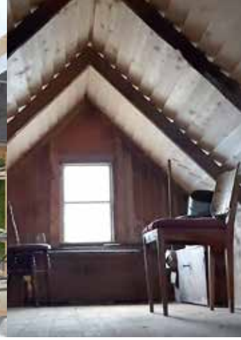
Skarsúð á 100 ára gömlum hjalli á Hvammeyri Tálknafirði. Ein af mörgum gömlum byggingum sem starfsmenn Tv-verk hafa gert upp.
