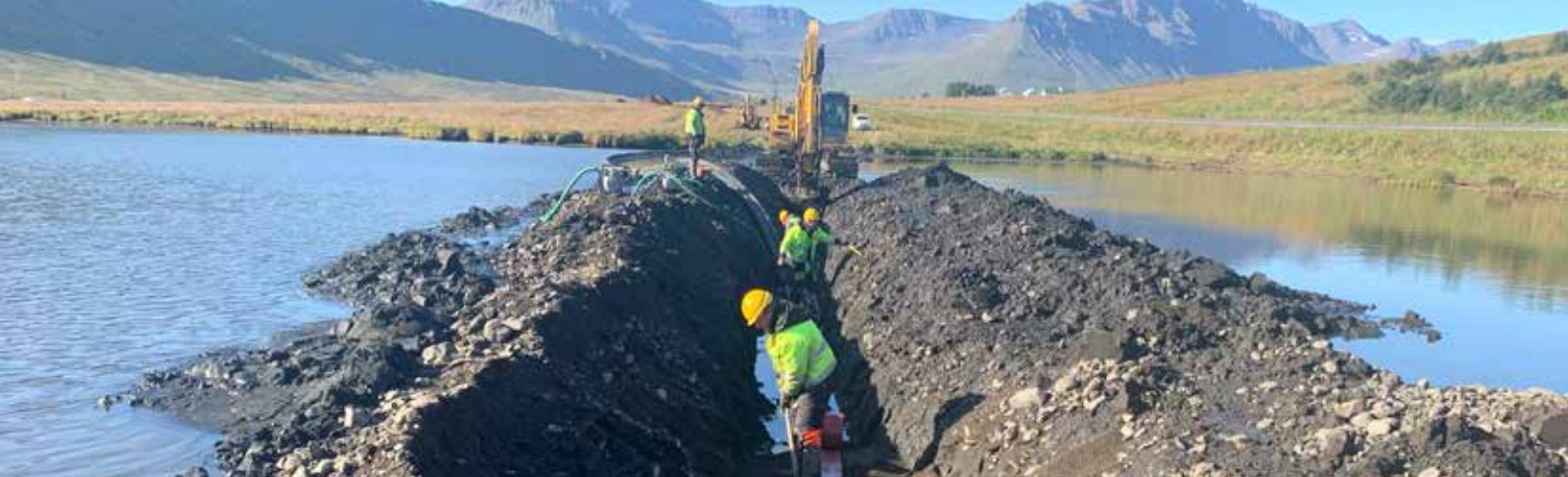
Strenglagn yfir Leirur í Norðfirði, Neskaupsstaðarlína 2. (2020).
