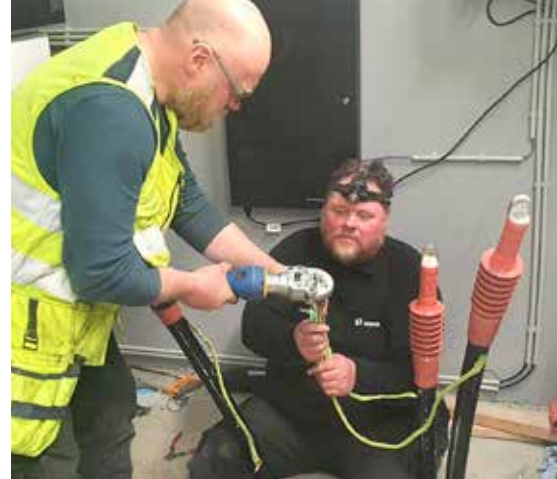
Guðmundur Rúnar Halldórsson og Leifur Ólafsson tengja háspennustreng í gagnaveri. / Ljós m. Jónas Þór Sigurgeirsson.
