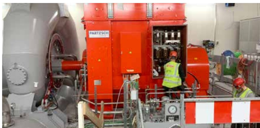
Leifur Ólafsson og Guðmundur Rúnar Halldórsson tengja rafala í vatnsaflsvirkjun. / Ljós m. Sigurgeir Þór Jónasson.
