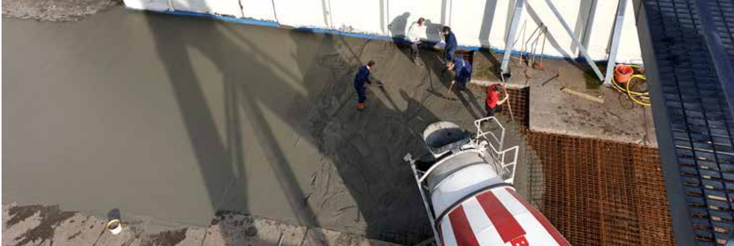
Steypa þekju við fiskimjölsverksmiðju Síldarvinnslunnar Elmarsz, Kristinn Örn, Ingibjörg, Skúli og Arnar.
