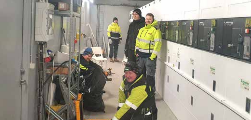
Hluti af starfsmönnum Átaks eftir vel heppnaða framkvæmd við stækkun gagnavers. Fannar Bjarnason, Valur Valsson, Vilhjálmur Agnarsson, Pétur Ari Zophoníasson og Anton Haraldsson. Ljós m. Jónas Þór Sigurgeirsson.
