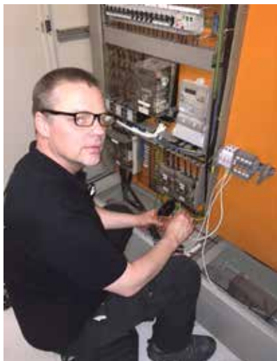
Steingrímur Ólafsson, framkvæmdastjóri. Mælaskipti fyrir Norðurorku 2015.
