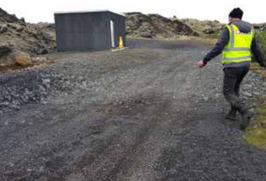
Unnið að dælustöðvum og lagningu vatnslagna í Heiðmörk fyrir Veitur. Jón Svan, eftirlit frá HNIT á mynd.
