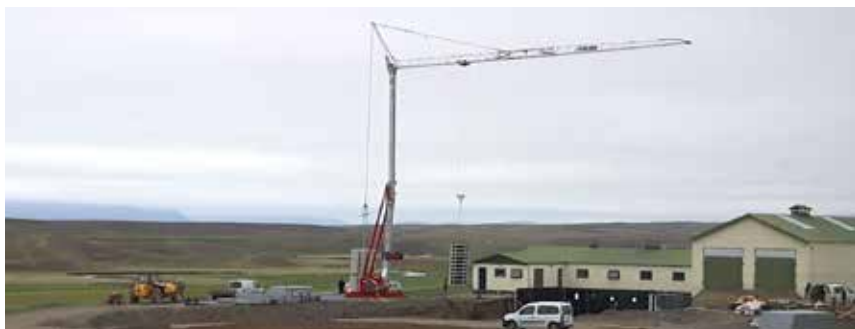
Nýr byggingarkrani í notkun á bænum Sólheimum í Sæmundarhlíð. / Ljós. Guðrún Kristín Eiríksdóttir.
