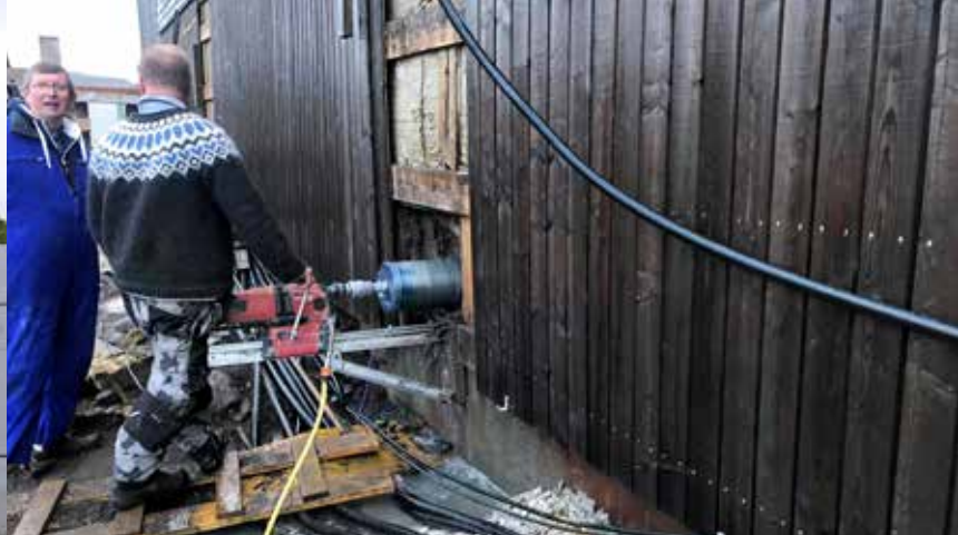
Steinþór við kjarnaborun ásamt einum af eiganda Saltverks í Saltverki Reykjanesi Ísafjarðardjúpi. / Ljósm. Edda Björk Magnúsdóttir.
